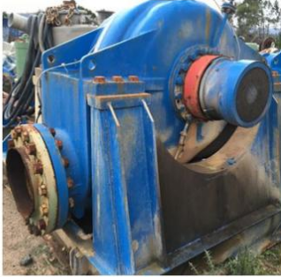
Bombas de agua gran caudal
